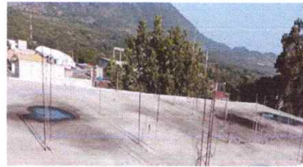
Foto 2: Problemas de encharcamiento en terraza.
