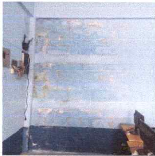
Foto 1: Problemas de exceso de humedad.
