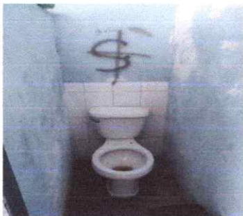
Foto 3: Baños en mal estado.
