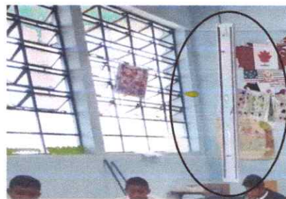
Foto 6: Lamparas caidas y sistema electrico no estable.
