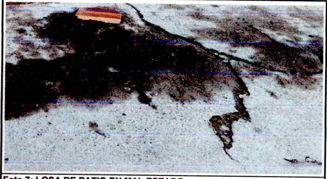
Foto 7: LOSA DE PATIO EN MAL ESTADO
