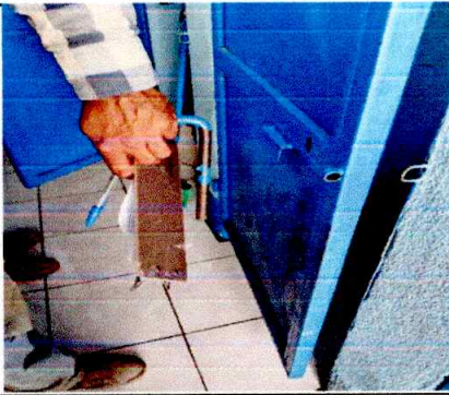
Foto 3: SE OBSERVA PUERTAS DAÑADAS
