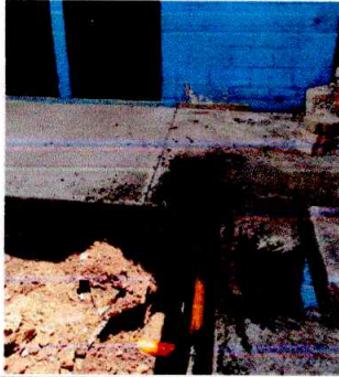
Foto 13: SE OBSERVA TUBERIAS DE DRENAJE DAÑADA
