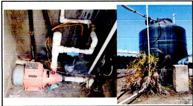
Foto 10: Cisterna y Bomba en mal estado
