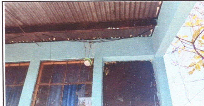
Mantenimiento del sistema Electrico
