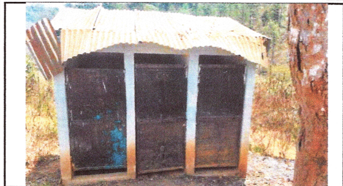
Foto1: cubierta de lamina de sanitario
