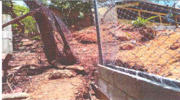
Foto 1: Cerco perimetral lado norte en mal estado.
