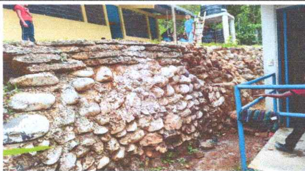
Foto 3: Muro de contención en mal estado.
