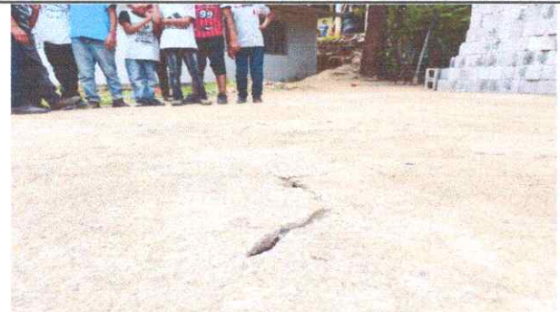
Foto 2: Losa de patio en mal estado.
