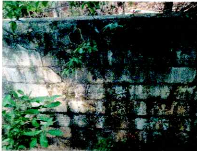
Foto 1: Muro Perimetral en mal estado.
