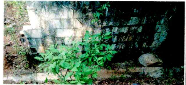
Foto 2: Muro perimetral deteriorado.
