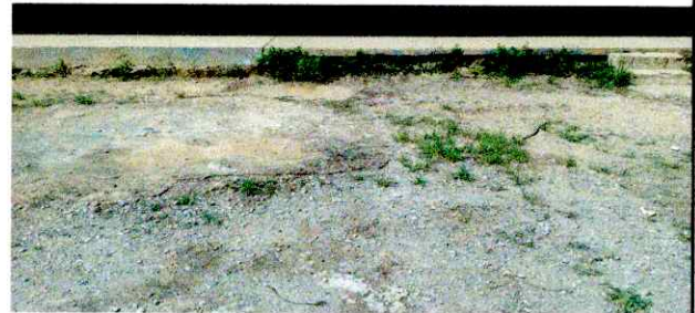
Foto 4: Losa en el patio de la escuela en mal estado.
