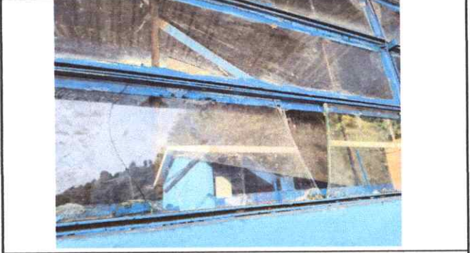
Foto 2: VENTANA EN MAL ESTADO.
