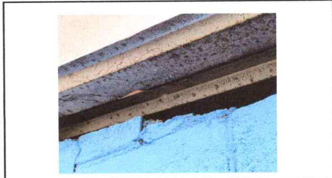
Foto 3: CANALES Y BAJADAS DE AGUA PLUVIAL EN MAL ESTADO
