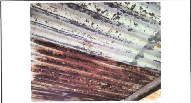
Foto1: CUBIERTA DE LAMINA Y ESTRUCTURA DE TECHO EN MAL ESTADO.
