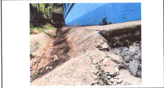
Foto 4: CUNETA DE CONCRETO EN MAL ESTADO.
