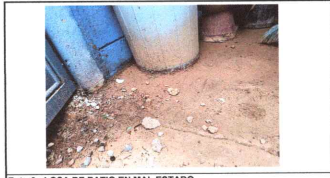
Foto 6: LOSA DE PATIO EN MAL ESTADO.
