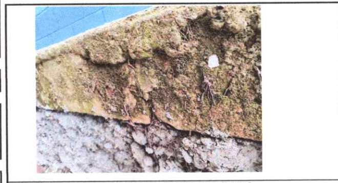
Foto 5: CERCO MURO PERIMETRAL EN MAL ESTADO
