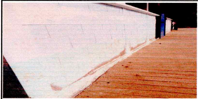
Foto 7: PINTURA DETERIORADA DEL CENTRO EDUCATIVO
