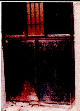
Foto 3: PUERTA EN MAL ESTADO
