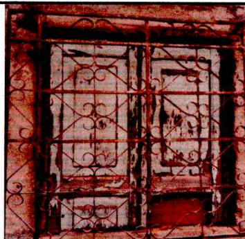
Foto 4: VENTANA EN MAL ESTADO
