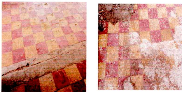
Foto 5: PISO EN MAL ESTADO EN LA DIRECCION
