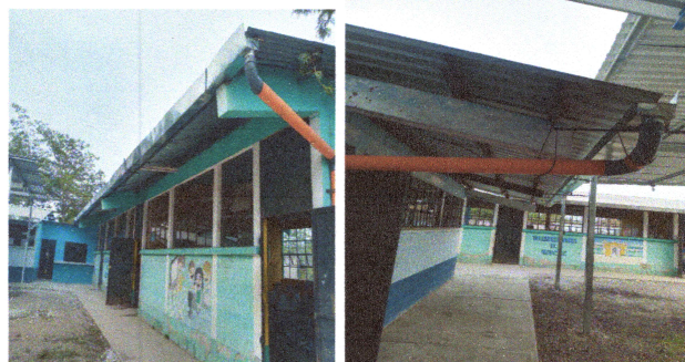
Foto 4: Canales y bajadas de aguas pluviales
