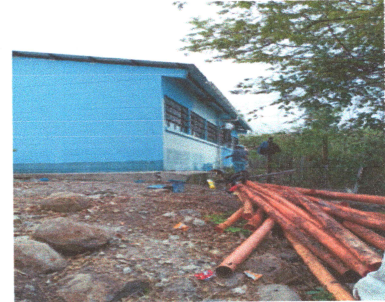
Foto 2: tubería quitada que estaba en mal estado
