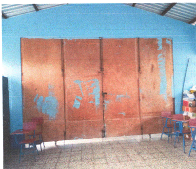
Foto 5: puerta de interior en mal estado
