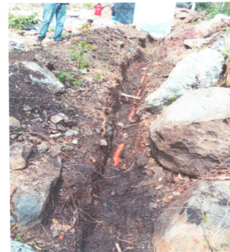
Foto 4: descubrimiento de tubería que estaba en mal estado
