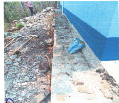
Foto 6: banquetas en mal estado
