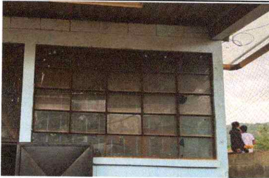
Foto 3: Ventanas requieren mantenimiento y cambio de vidrios quebrados en toda la escuela.
