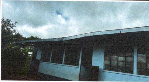
Foto 1: Canales en mal estado.
