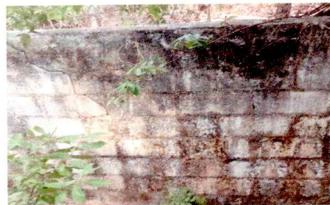
Foto 6: SE OBSERVA PAREDES DETERIORADA
