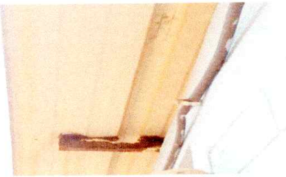
FOTO 3: SE OBSERVA LA ESTRUCTURA DE TECHO EN MAL ESTADO
