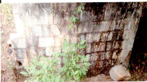
FOTO 5. MURO PERIMETRAL EN MAL ESTADO
