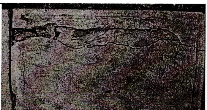
Foto 6: se observa losa en mal estado.
