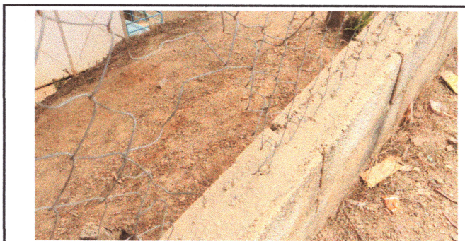
Foto: 5 MAYA DE CERCO EN MAL ESTADO
