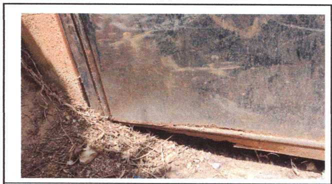
Foto4: PUERTAS EN MAL ESTADO
