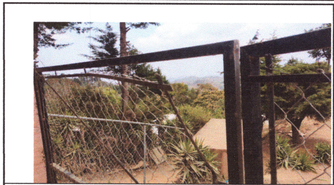
FOTO 2: PORTON EN MAL ESTADO
