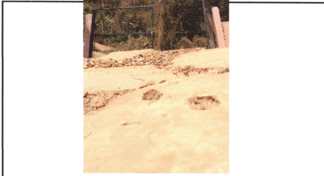
Foto1: LOSA DE PATIO EN MAL ESTADO
