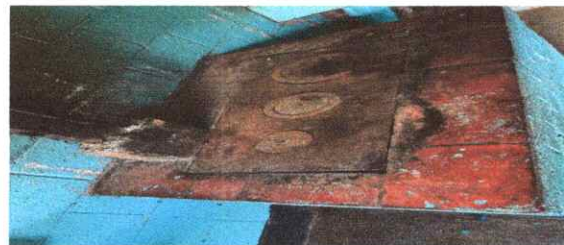
Foto 6: ESTUFA RURAL DETERIORADA SUSTITUCION
