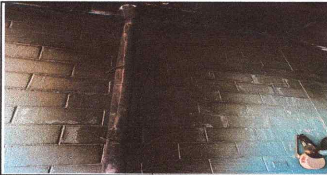
Foto 5: CHIMENEA DETERIORADA SUSTITUCION
