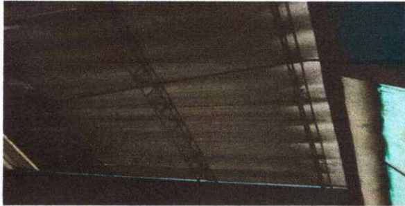
Foto 3: ESTRUCTURA DAÑADA SUSTITUCION
