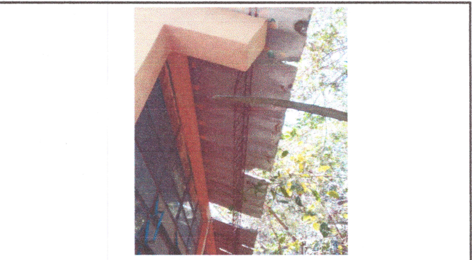
Foto 4: Techo en mal estado el cual será reparado
