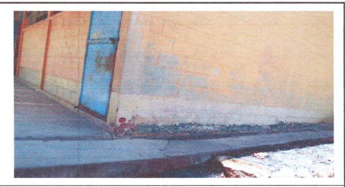
Foto 6: Banquetas en mal estado.
