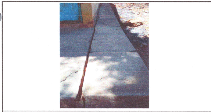
Foto 5: Banqueta en mal estado
