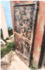
Foto 11: Puerta de baños en mal estado
