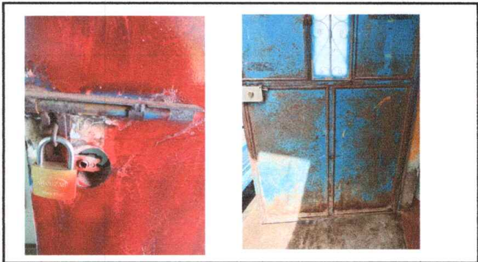
Foto 2: Puertas de aulas dañadas
