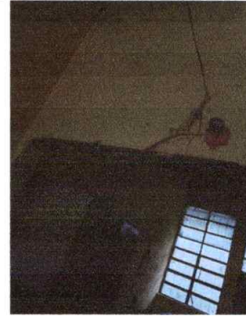
Foto 8: Se observa conexión eléctrica en mal estado.
