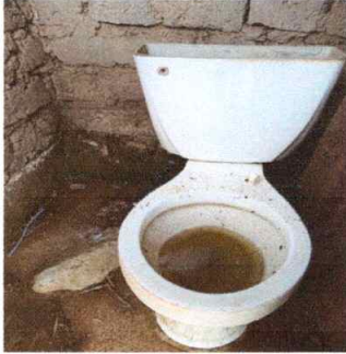
Foto 7: pared de baños dañada y en mal estado
