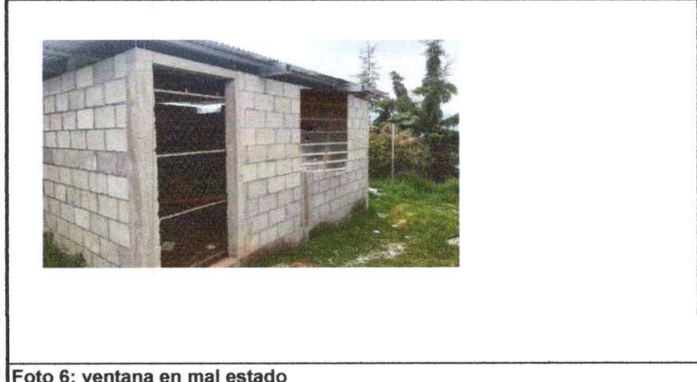
Foto 6: ventana en mal estado
