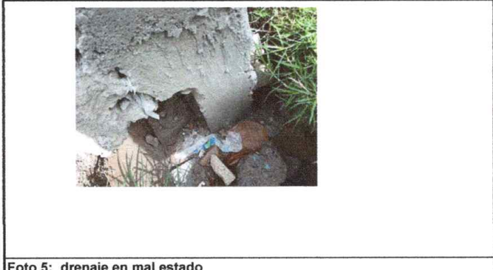
Foto 5: drenaje en mal estado
