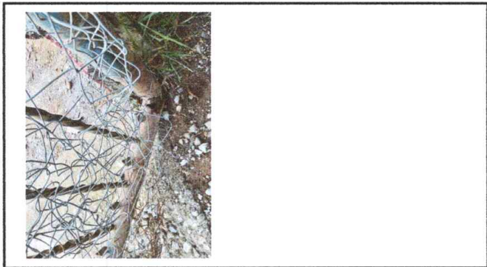
Foto 4: Se observa portón roto y en mal estado.
