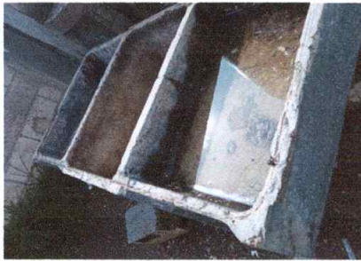
Foto 9: Pila en mal estado
