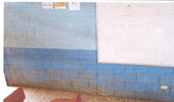
Foto 6: Sustitución base aceite (zócalo)
