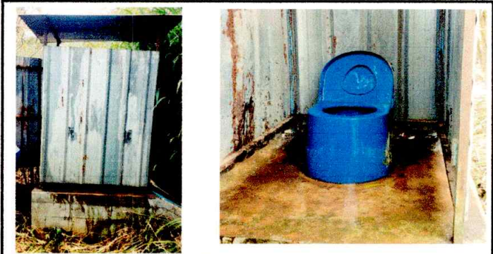
Foto: 5 SERVICIOS SANITARIOS Y SUS ACCESORIOS
