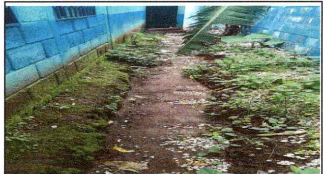
Foto 4: ES NECESARIO UNA CUNETETA DE CONCRETO
