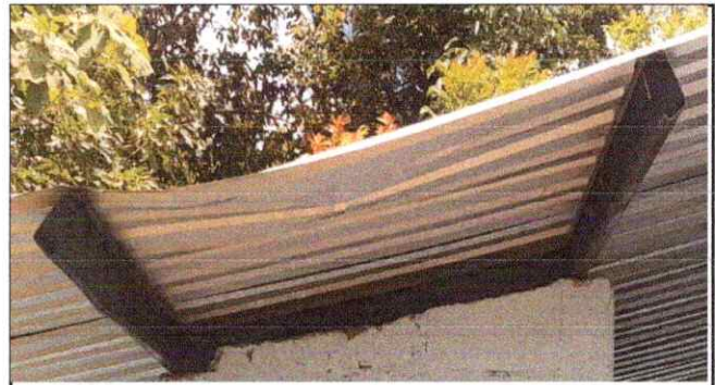
Foto 2: SE EVIDENCIA ESTRUCTURA DE METAL EN MAL ESTADO
