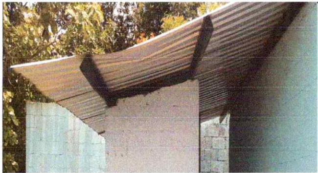
Foto1: SE OBSERVA LAMINA EN MALAS CONDICIONES
