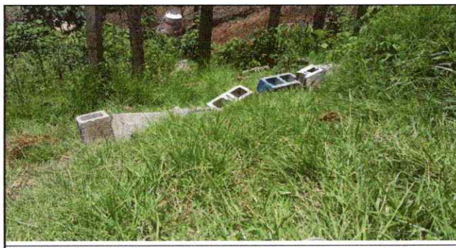
Foto 5: SE NECESITA MURO PERIMETRAL
