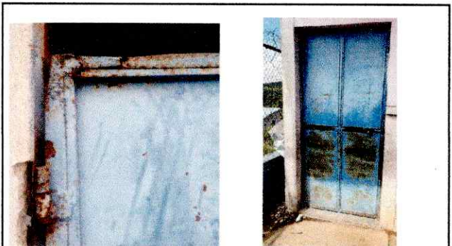
Foto 4: PUERTA DE BAÑO EN MALAS CONDICIONES, PUERTAS DE AULAS EN MAL ESTADO
