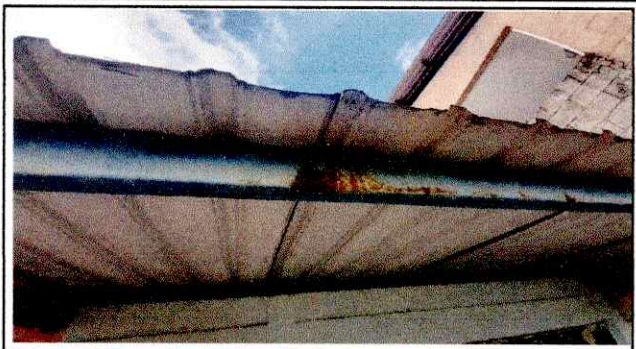
Foto 2: SE OBSERVA LA ESTRUCTURA SIN COLOR Y CON OXIDO, LAMINA CON FILTRACIONES
