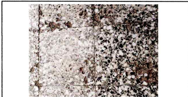
Foto 5: PISO DE GRANITO EN MAL ESTADO
