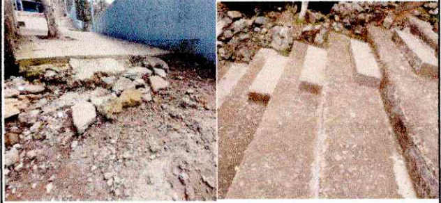
Foto 8: LOSA DE PATIO EN MALAS CONDICIONES
