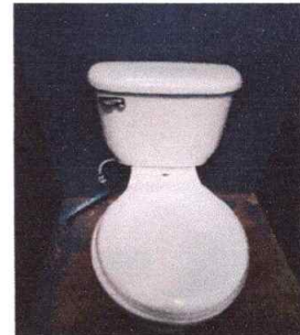
Foto 2: Servicios sanitarios y sus accesorios
