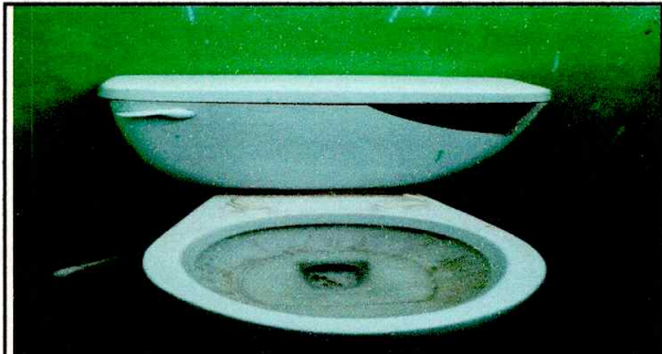
Foto 2: Servicios sanitarios y sus accesorios
