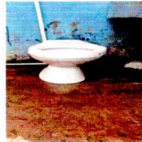
Foto 4: Sanitarios en mal estado.
