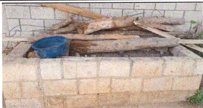
Foto 7: AREA DE COCINA EN MAL ESTADO, ES NECESARIO LA ESTUFA RURAL
