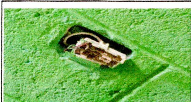
toma corriente en mal estado
