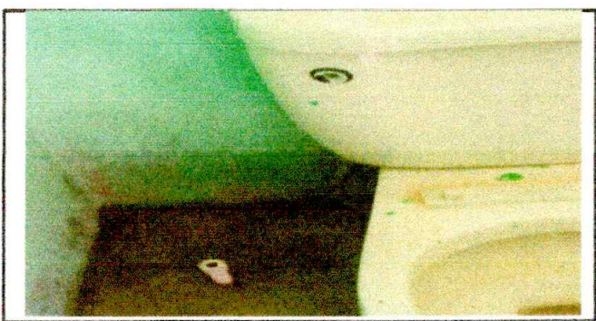
baño en mal estado
