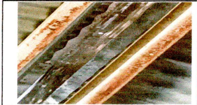
Techo en mal estado
