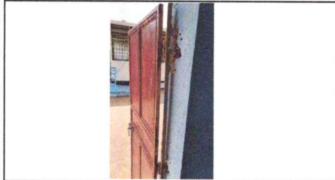
Foto 1: Puerta de sanitario en mal estado
