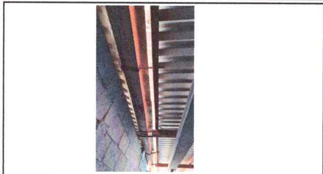
Foto 2: canal que se encuentra en la parte interna de un aula el cual es muy bajo y angosto lo que provoca que el agua se rebalse.
