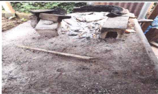
Foto 5: COCINA EN MAL ESTADO A PUNTO DE CAERSE
