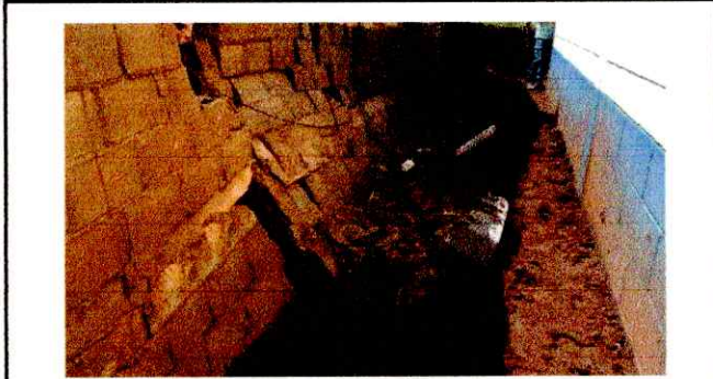
Foto 1: Muro de contención colapsado
