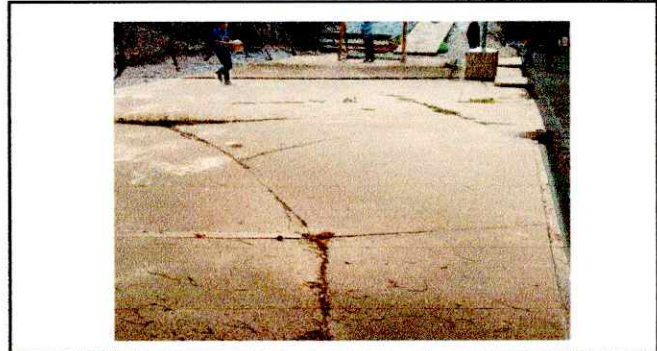
Foto 4: Losa de patio con grietas y hundimiento
