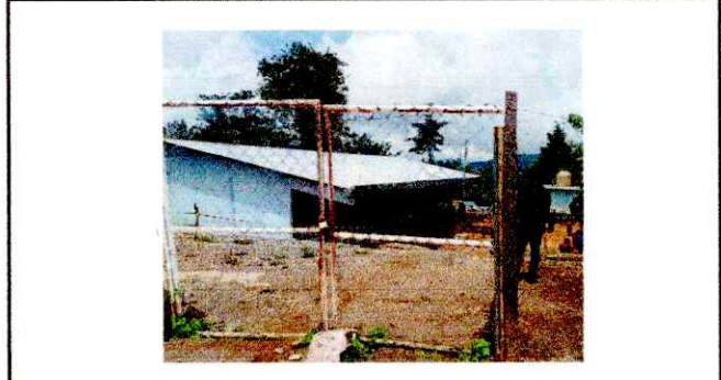
Foto 2: Portón en mal estado
