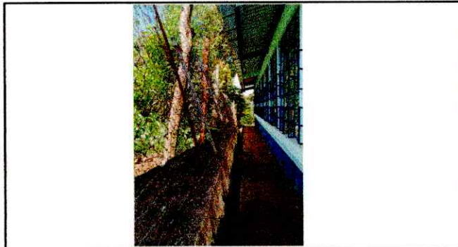
Foto 3: Muro perimetral en deterioro
