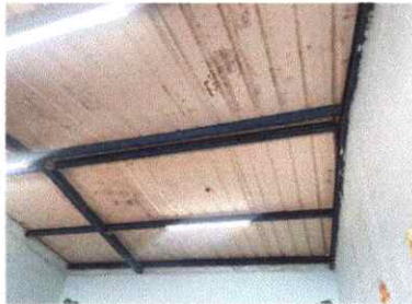
Foto 1: Sustrucción de lámina en mal estado
