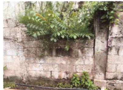
Foto 6: Sustrucción de muro perimetral en mal estado.
