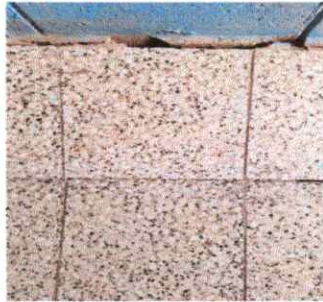
Foto 3: Sustrucción de piso en mal estado
