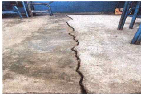
Foto 4: Sustrucción de piso de cemento en mal estado
