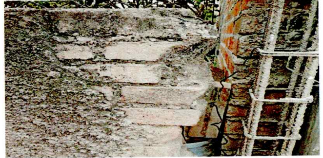
Foto 4: se requiere reparación del muro perimetral
