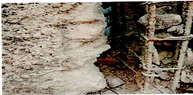
Foto 3: se requiere reparación del muro perimetral
