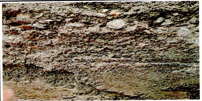
Foto 6: se requiere repello y cernido de los muros.
