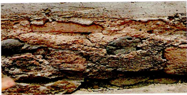
Foto 5: Se requiere repello y cernido de los muros.
