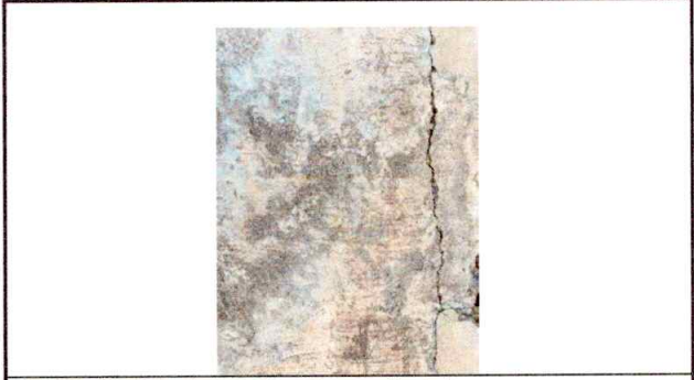
FOTO 2: Se evidencia losa de patio en mal estado
