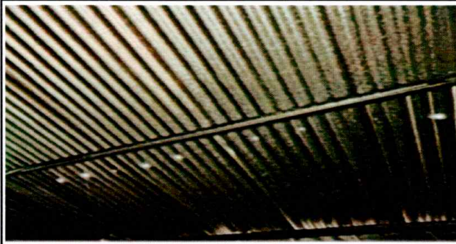
Foto1: En esta fotografía se observa la lámina con agujeros y estructura de techo deficiente.
