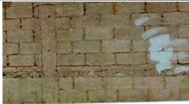
Foto 3: Se aprecia el deterioro de pared por deterioro de repello.
