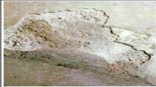
Foto 2: en Esta fotografía se aprecia la loza de patio o torta en deterioro.
