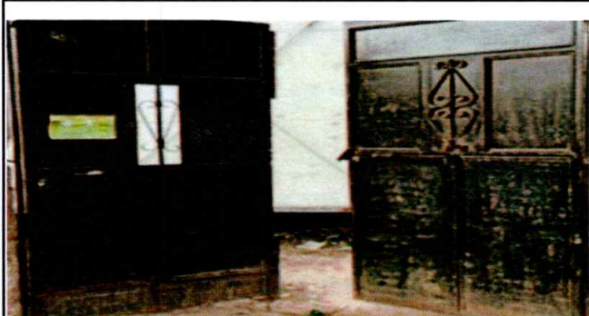
Foto 4: Se puede apreciar el deterioro de las puertas en la parte baja.
