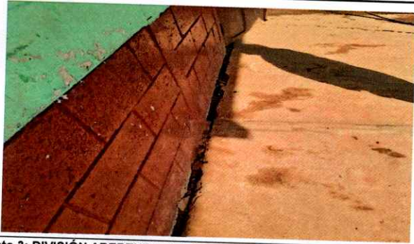
Foto 3: DIVISIÓN ABERTURA DEL PISO DE LA PARED
