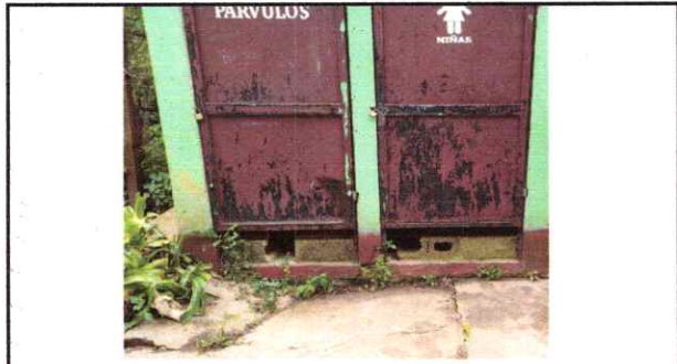
Foto 2: PUERTAS. SE CAMBIARAN LAS PUERTAS EN MAL ESTADO
