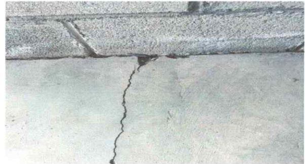
Foto 2: DETERIORO DE TORTA DE CEMENTO
