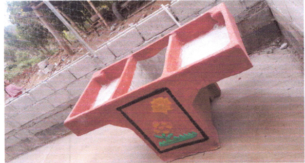
Foto 2: SUMINISTRO E INSTALACIÓN DE PILA DE DOS LAVADEROS EN ÁREA EXTERIOR DE COCINA.
