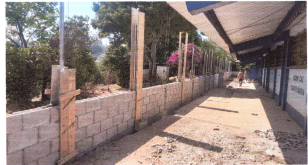
Foto 4: SUMINISTRO E INSTALACIÓN DE MURO DE CERRAMIENTO CON INSTALACIÓN DE MALLA HEXAGONAL CON TUBO GALVANIZADO DE 2"
