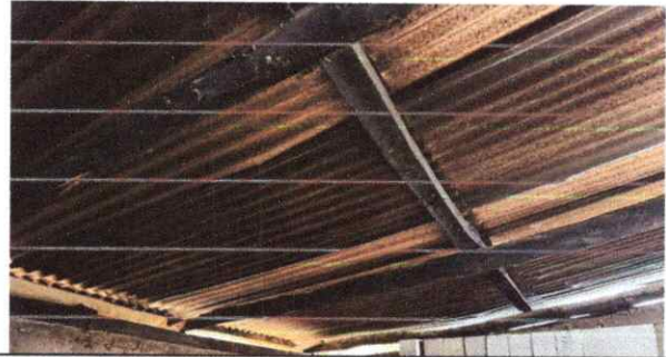
Foto 2: Lámina que necesita cambio.
