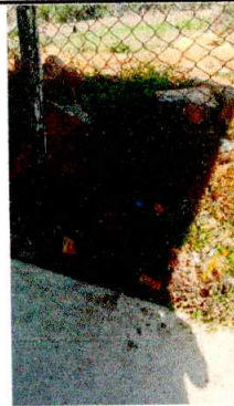
Foto 2: es necesario sustituir la malla y colocar mas hiladas de block.
