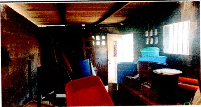
Foto 5: Paredes de la cocina muy bajas.
