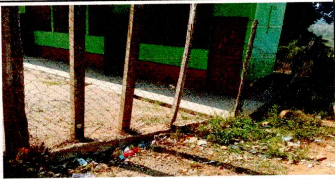
Foto 1: muro perimetral en mal estado
