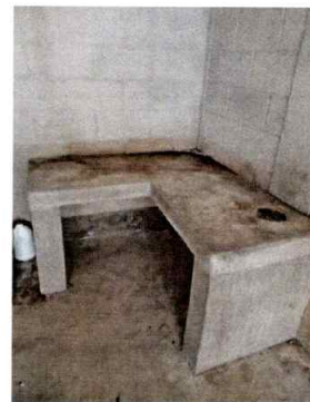
Foto 4: Cocina en mal estado
