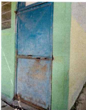
Foto 3: Puertas de aula en mal estado
