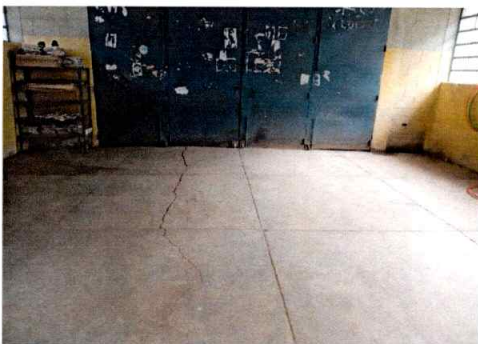
Foto 5: Piso de aulas en mal estado
