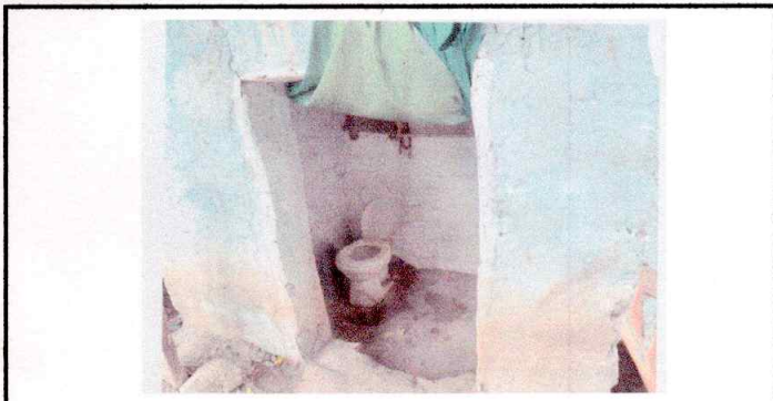
Foto 1: Cuatro de sanitarios en mal estado
