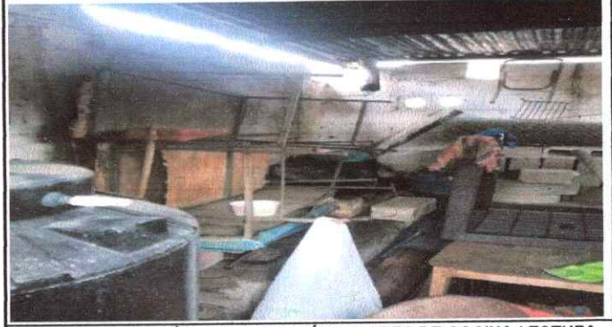
FOTO 8: REPARACIÓN O SUSTITUCIÓN DE AREA DE COCINA ( ESTUFA RURAL, VENTANA, PUERTA, PAREDES Y CHIMENEA )
