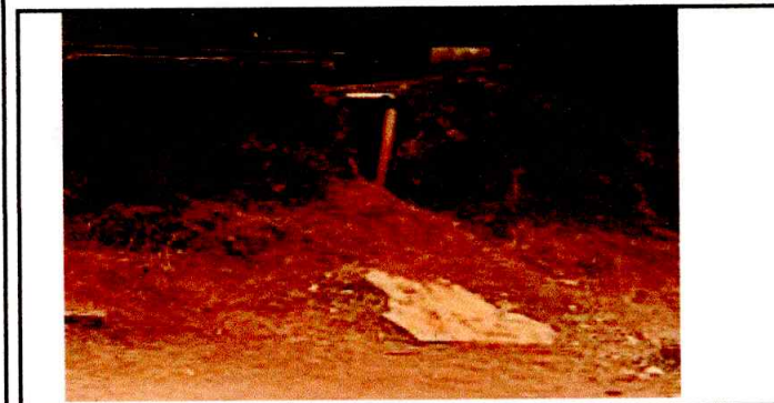
Foto 5: SE OBSERVA EL RIESGO INCLUSO DE LASTIMAR DRENAJES
