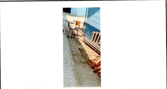
Foto 1: Red de drenaje en mal estado.
