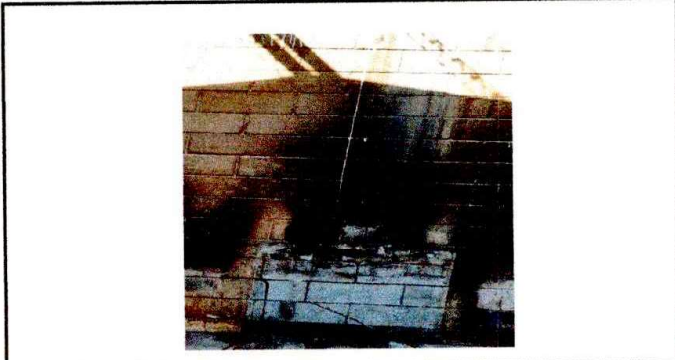
Foto 3: paredes de la cocina dañadas.
