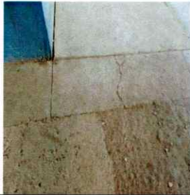
Foto 3: LOSA DE PATIO QUEBRADA
