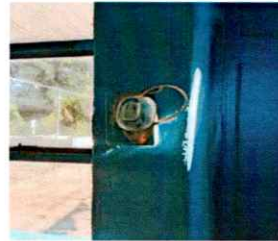
Foto 4: INTERRUPTORES DE LAMPARAS EN MAL ESTADO
