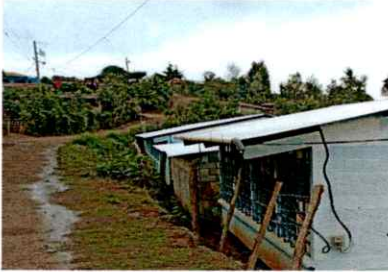
Foto 4: CANALES Y BAJADAS DE AGUA EN MAL ESTADO
