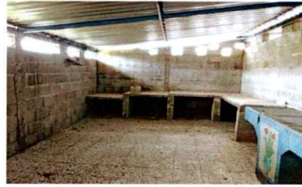
Foto 2: REPARACIÓN Y SUSTITUCIÓN DE COCINA CON 3 ESTUFAS RURALES CON CHIMENEA DEBIDO AL MAL ESTADO
