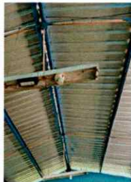
Foto 5: SUSTITUCIÓN DE LAMPARAS DEBIDO AL MAL ESTADO
