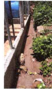
Foto 2: No existen cunetas adecuadas para que fluya el agua de lluvia.
