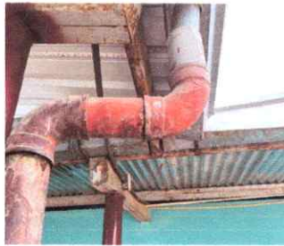
Foto1: Se puede observar deterioro de Canal y bajadas de Agua
