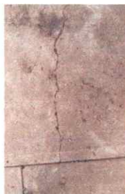
Foto 4: Se puede evidenciar mal estado de Losa
