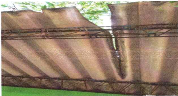
Foto 1: CUBIERTA DE LAMINA: Lamina en mal estado.
