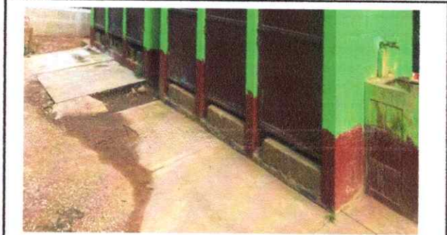
FOTO 7: DRENAJE EN MAL ESTADO
