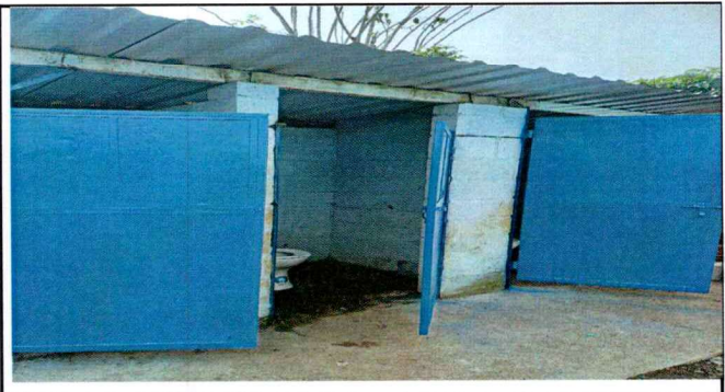
Foto 4: servicios sanitarios y sus accesorios
