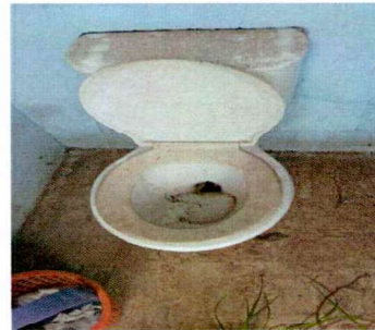
Foto 4: Servicios Sanitarios y sus accesorios
